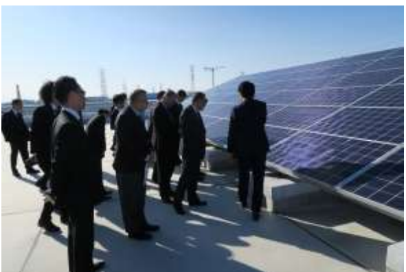
マイクログリッドシステムの太陽電池モジュール
