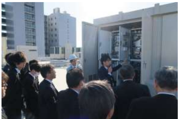
マイクログリッドシステムの蓄電池盤
