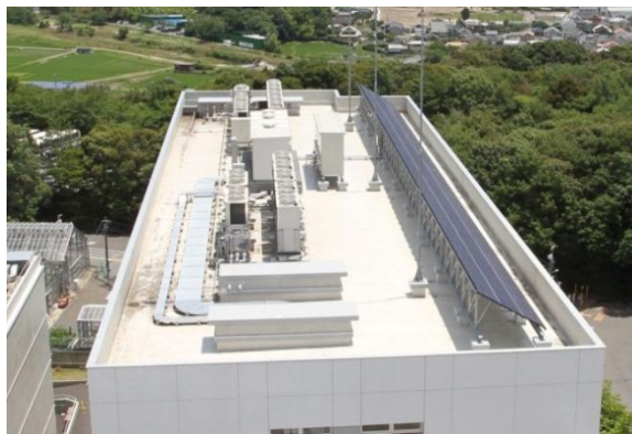
55号館太陽光発電+蓄電システム
