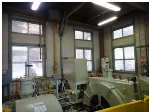
発電所内の発電機と2台の水車
