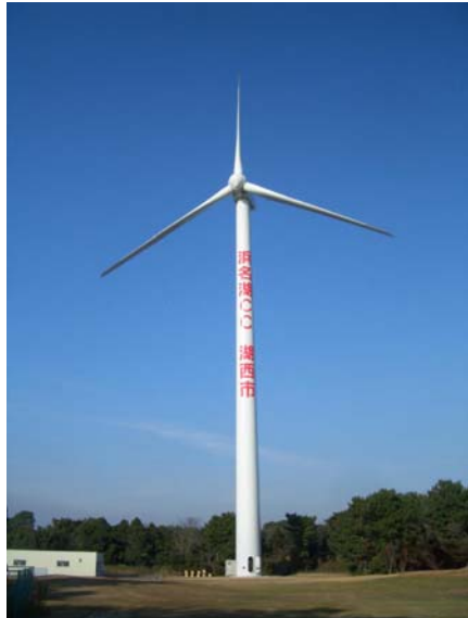
風力発電設備 1000kW
